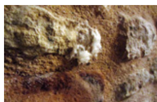
Dépôt de salpêtre signe d'humidité (doc. ISOSEC)
