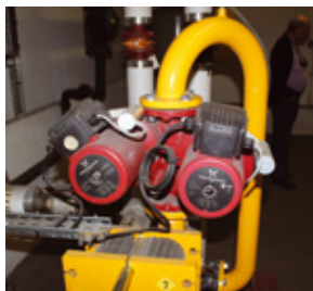
Système de distribution Pompes et circulateurs (doc. ESPACE9)
