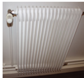
Radiateurs à eau chaude (doc. ESPACE9)
